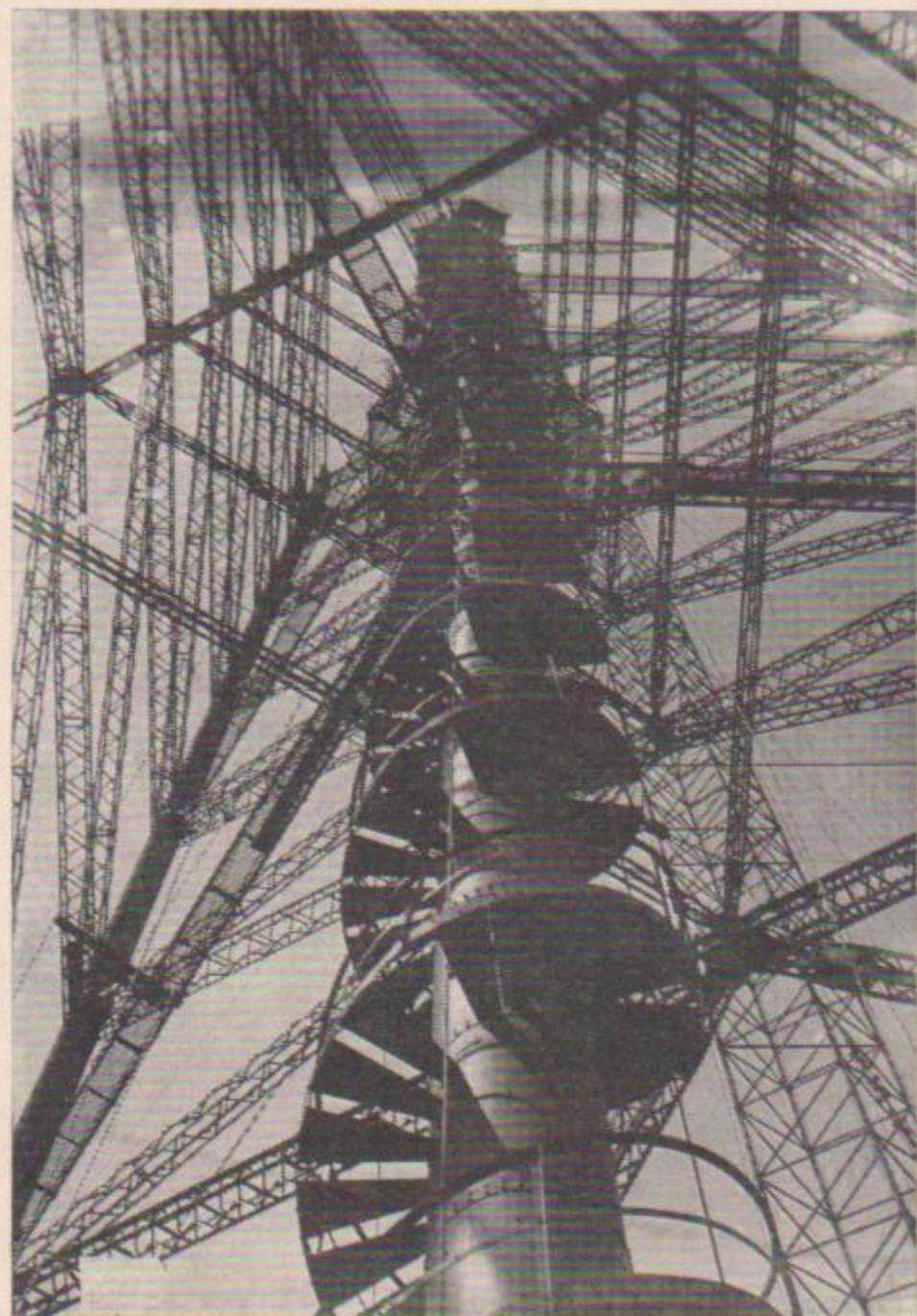
Blick in das Innere des 243 m hohen Mittelturms mit der Wendeltreppe am Senderhaus 3.
